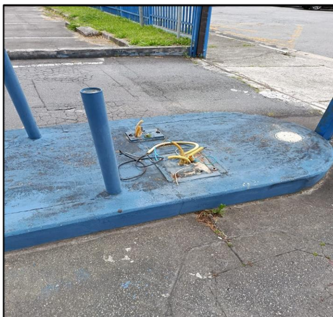
- Tubulação e cabeamento danificados por vandalismo
