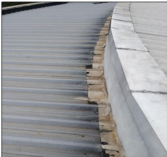
- Manta e rufo que com sinais de desgaste
