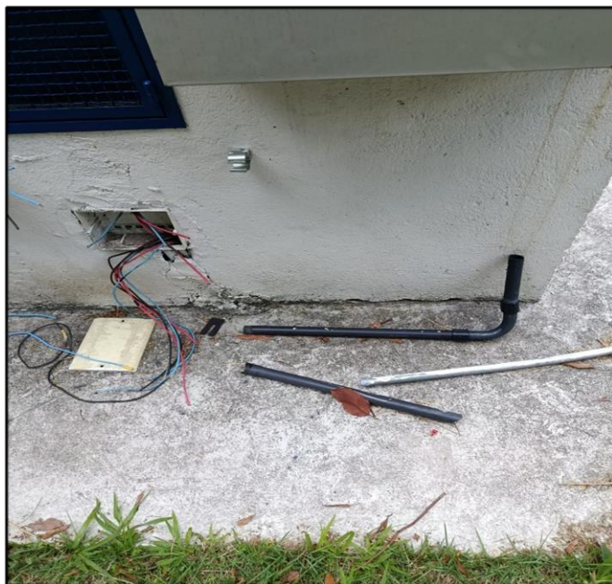
- Caixa de passagem com cabos furtados - inoperante
