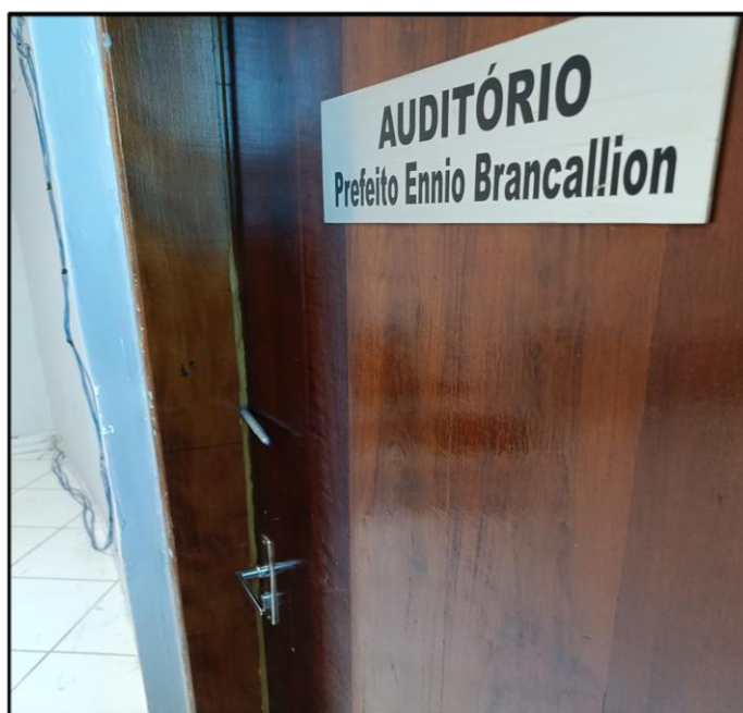
- Batente da porta com defeito estrutural
