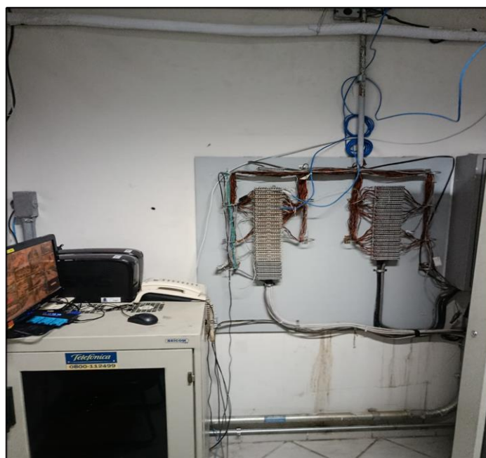
- Painele de telefonia e equipamentos de segurança
