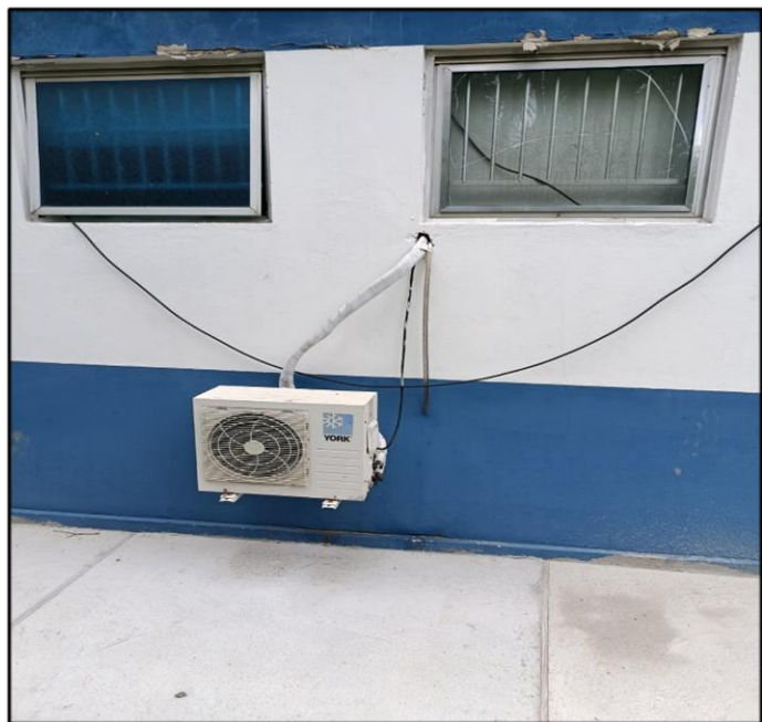
- Extensão elétrica improvisada - Falha na rede elétrica
