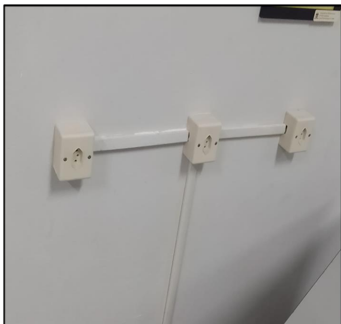
- Tomadas instaladas de forma improvisada
