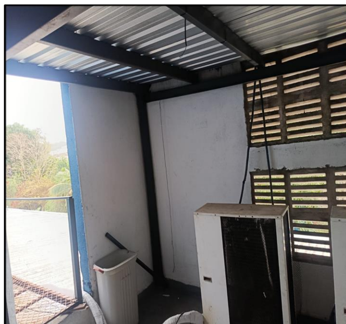
- Adaptar a ventilação na segunda casa de máquinas
