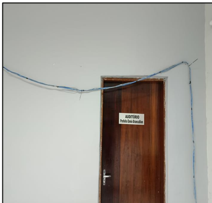
- Estrutura de cabeamento de rede irregular
