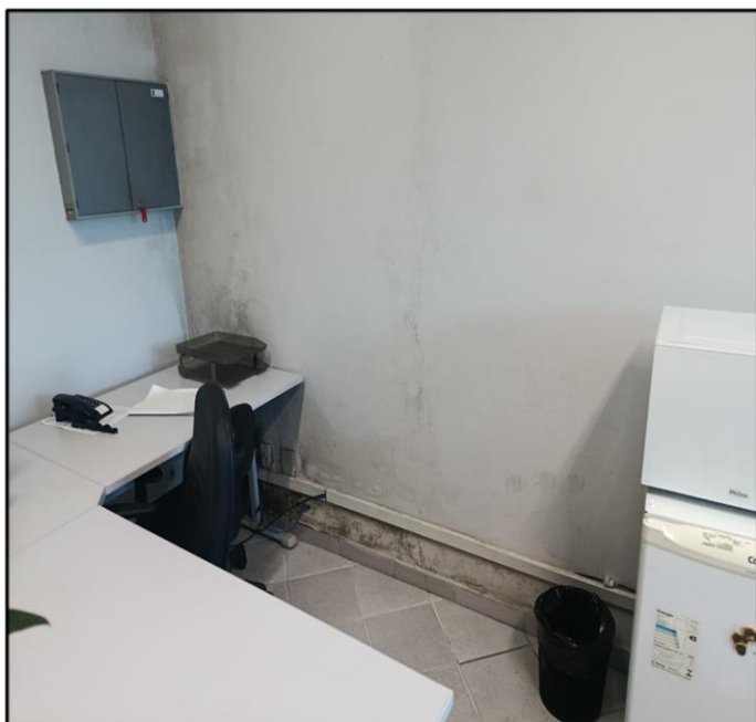
- Face interna da parede evidenciando umidade
