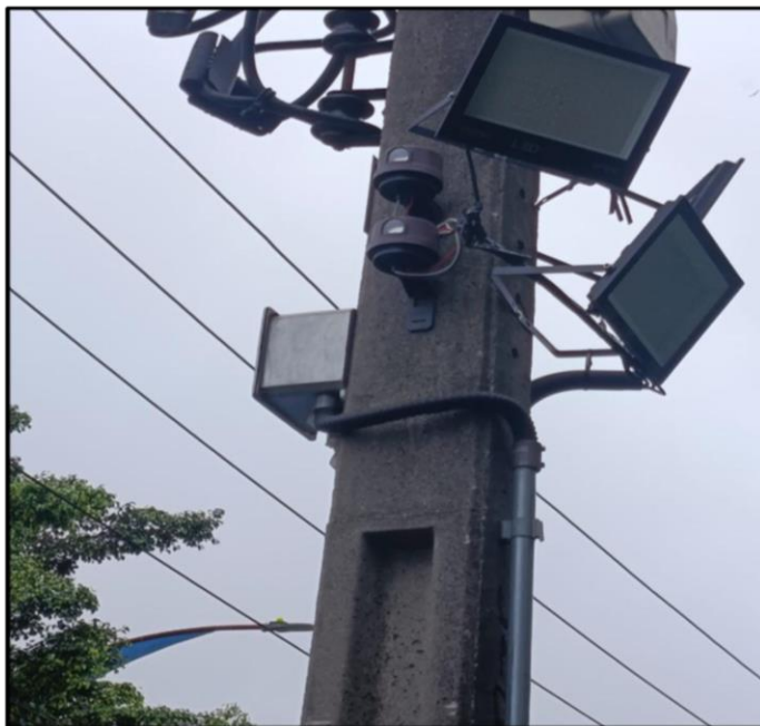
- Fotocélula para controle da iluminação do jardim
