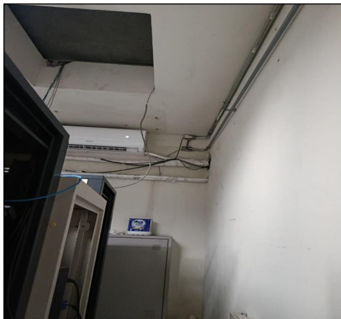
- Estrutura da claraboia em mau estado
