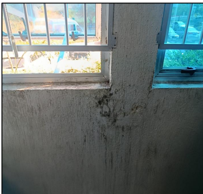
- Manchas de bolor devido as infiltrações externas
