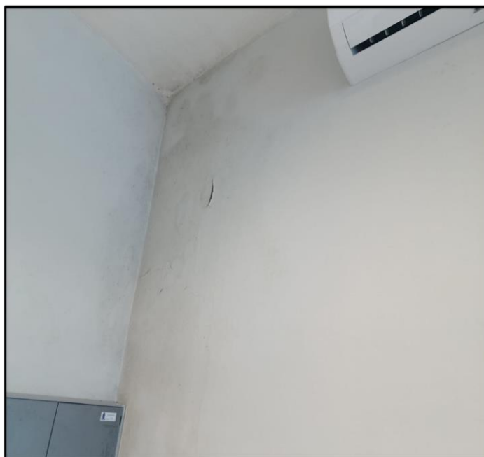
- Descascamento na alvenaria devido à umidade
