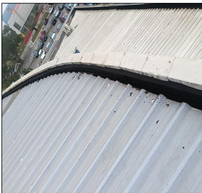
- Vista com água acumulada, falha no escoamento
