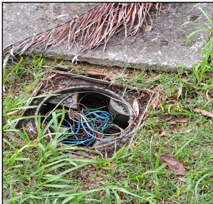
- Caixa de passagem danificada por vandalismo
