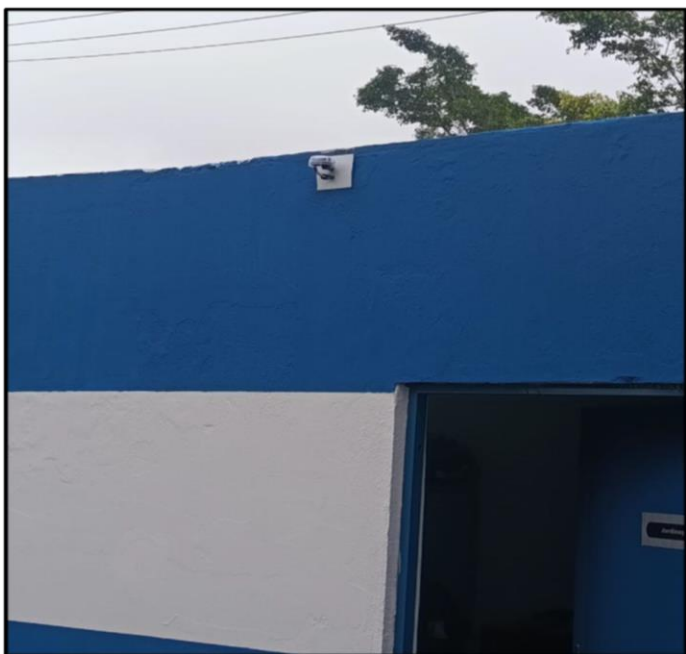
- Fotocélula que aciona as luminárias do jardim
