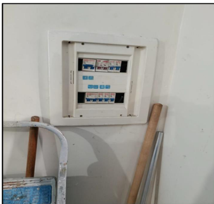
- Quadro de disjuntores da sala da jardinagem
