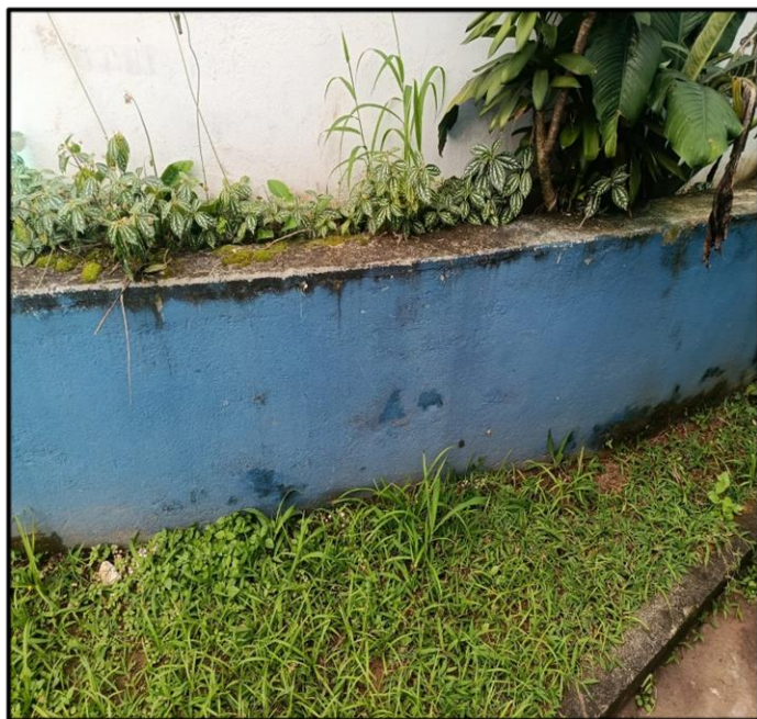
- Saturação hídrica na parede divisória com a Diretoria.
