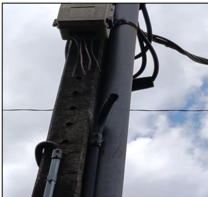
- Rompimento intencional dos cabos da fotocélula
