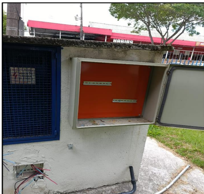
- Quadro de distribuição ausente devido a furto
