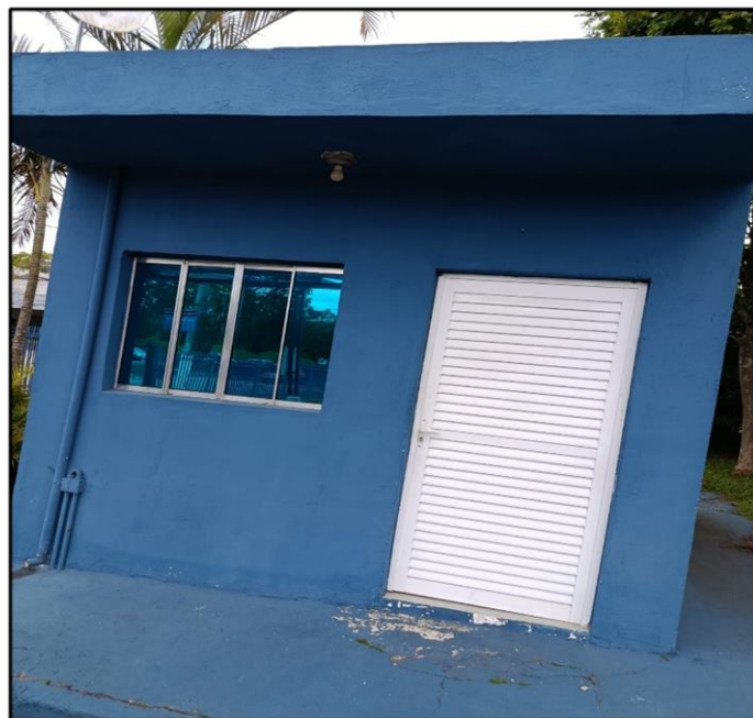
- Guarita de veículos, com rede elétrica comprometida
