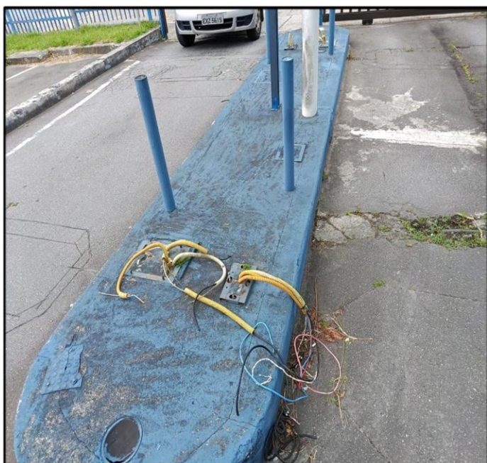
- Cabeamento da cancela de veículos - vandalizado
