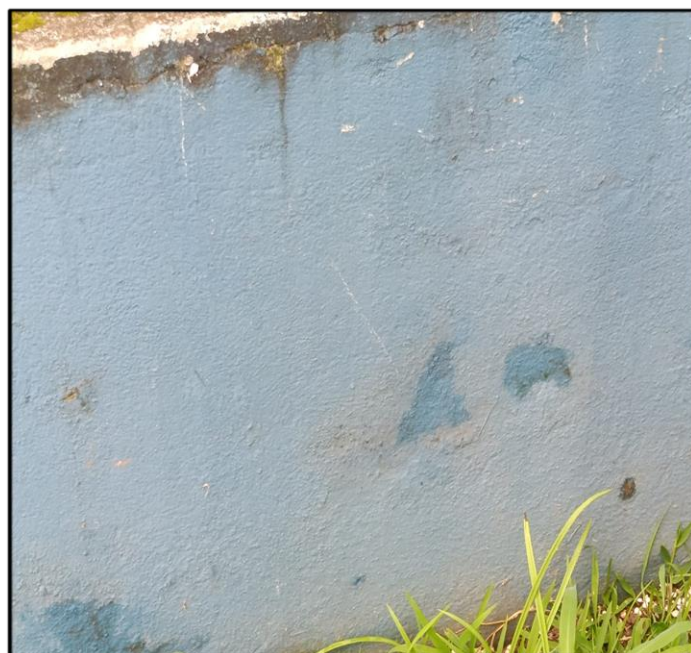
- Estrutura externa da jardineira com umidade
