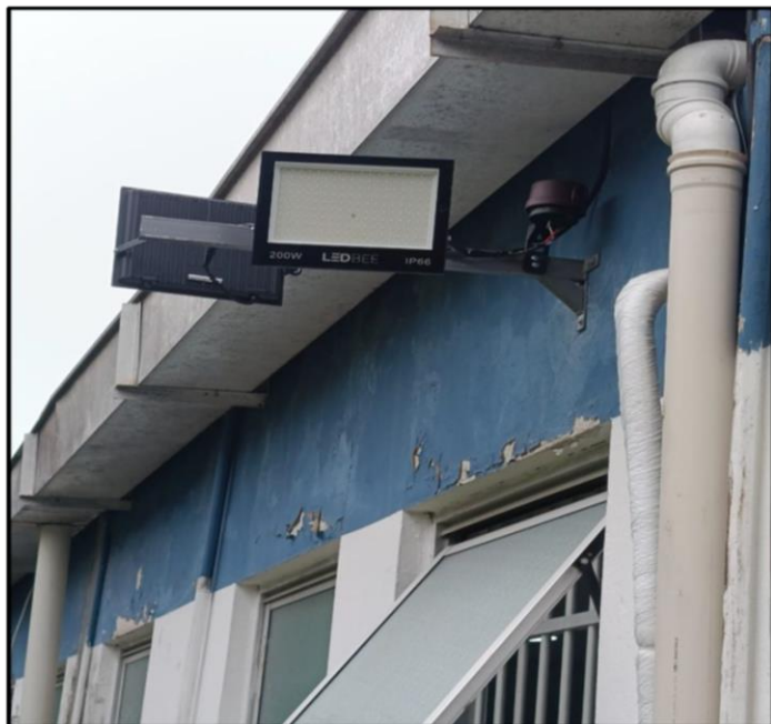
- Fotocélula para controle da iluminação externa lateral
