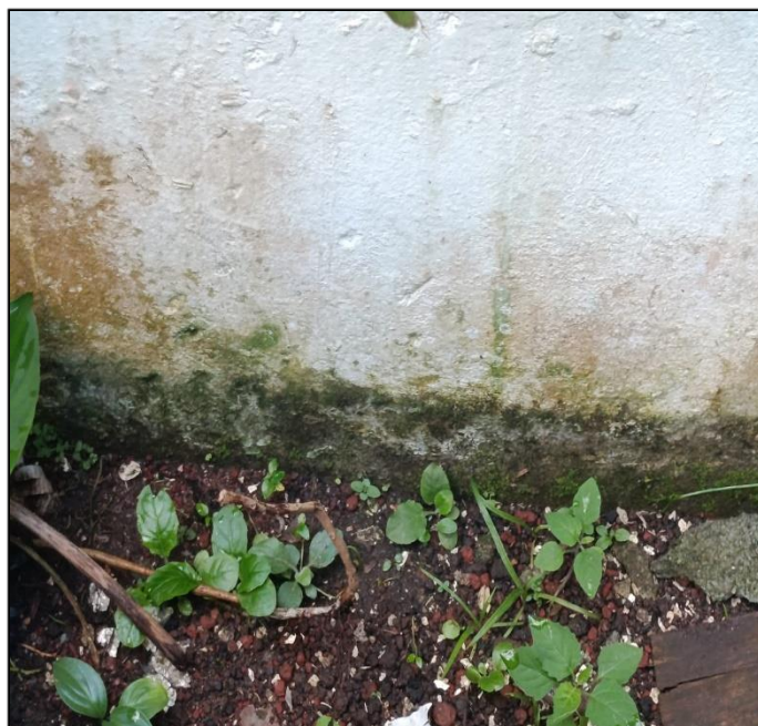
- Evidência de infiltração no acabamento externo
