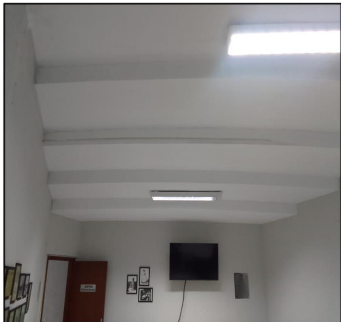
- Desgaste na pintura do teto
