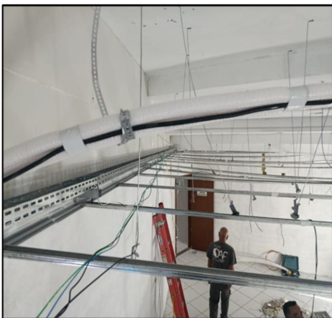
- Eletrocalha de rede elétrica, dados e voz.
