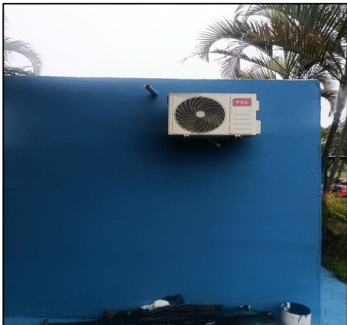
- AR Condicionado da guarita em funcionamento
