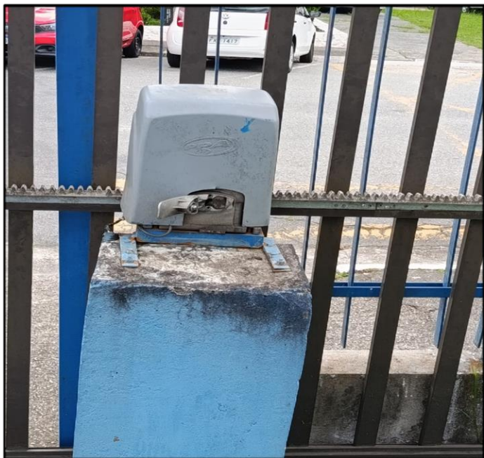
- Motor inoperante devido à ausência de energia
