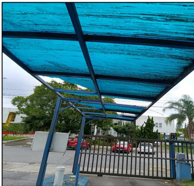
- Cobertura principal com danos estruturais
