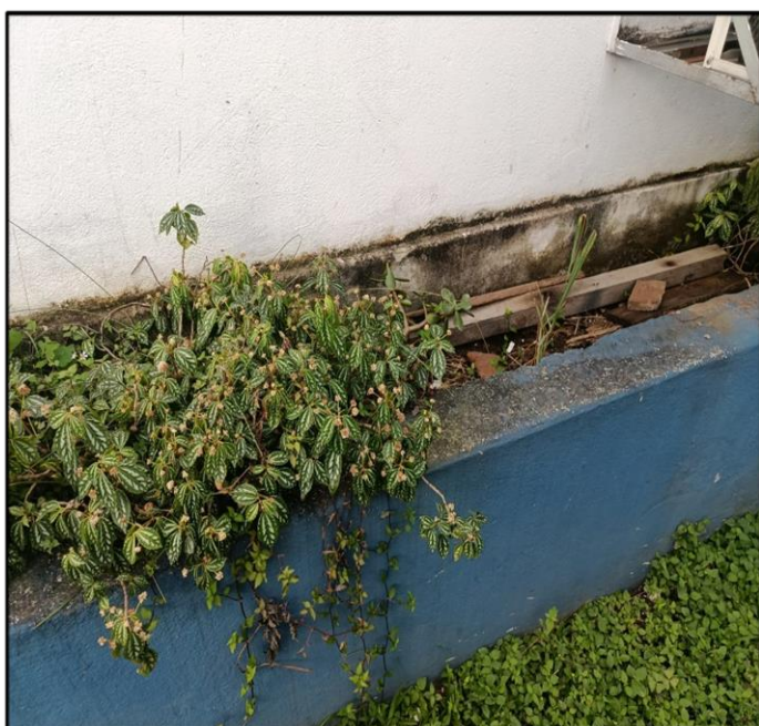
- Ausência de vedação no topo da jardineira
