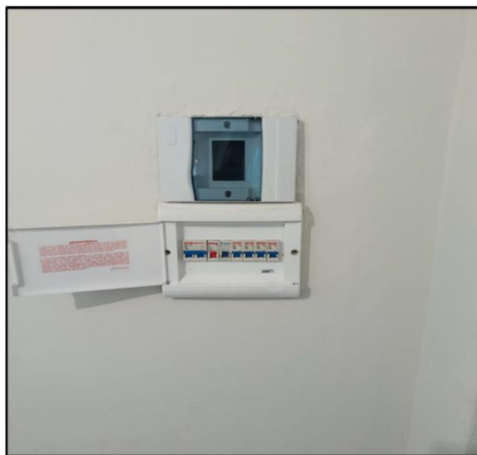
- Quadro de disjuntores da entrada de veículos
